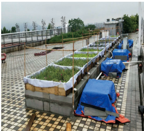
图 4 实时监测系统安装实景图
