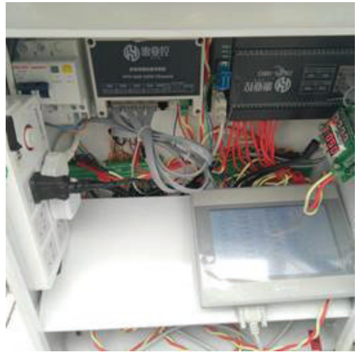
图 5 控制模块安装实景图
